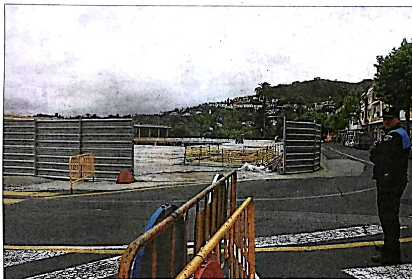
Casco de Santa Brígida. Imagen de archivo de la obra paralizada del centro comercial.
